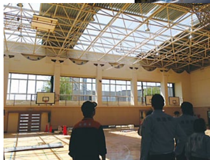
屋根が吹き飛ばされて空が見えている北陽中学校の体育館
